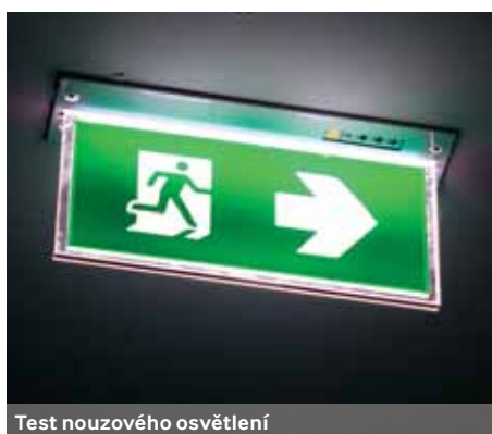
Test nouzového osvětlení
